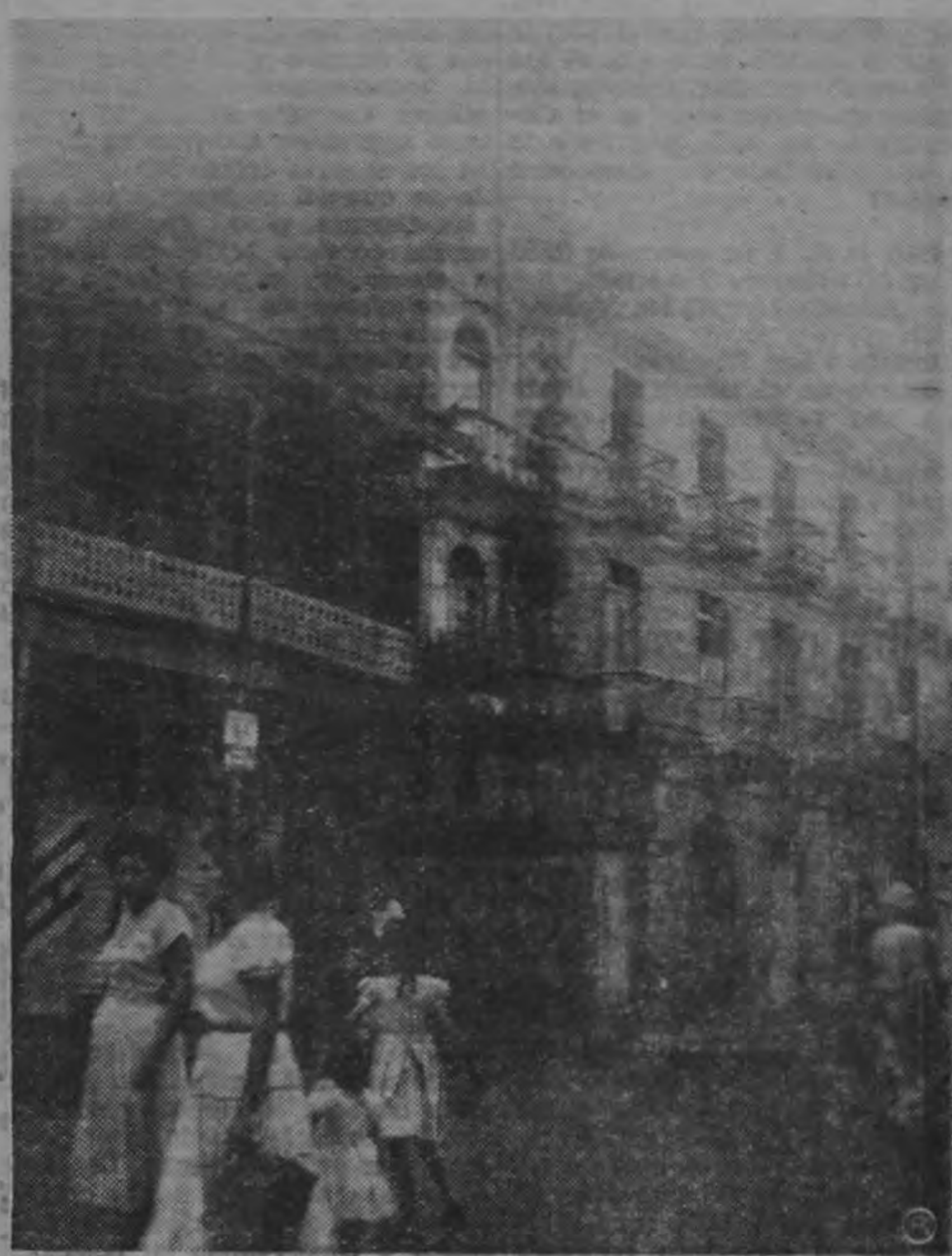
El edificio que aquí se ve, semi cubierto por la densa bruma que cayó sobre Limón en las primeras horas de la mañana, es el de la Pension Costa Rica, y ha quedado dividido como si hubiese sido cortado por un gigantesco cuchillo. Ha sido declarado inhabitable, y también tiene que trasladarse la Logia Masónica que ocupa el tercer piso (FOTO PERALTA)
